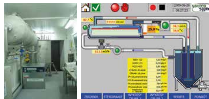
Ryc. 11. Fotokatalityczna mobilna instalacja do oczyszczania ścieków: (a) wnętrze kontenera z instalacją; (b) schemat ze sterowaniem automatyczną i pomiarami Źródło: Archiwum własne.
